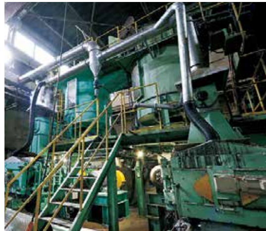
固形燃料化施設
