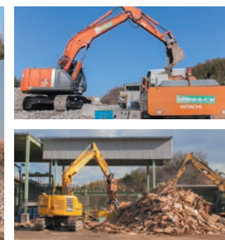
木くず破碎施設
