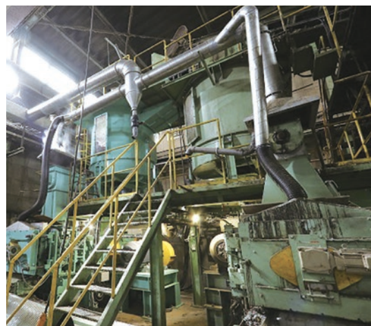
固形燃料化施設
